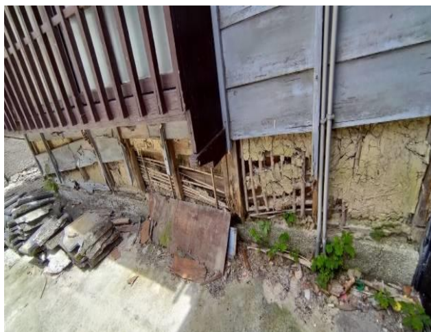
屋外雨淋板遭白蟻嚴重蛀蝕毀壞
