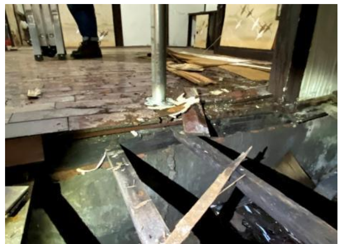
布基礎上方的土台現況
