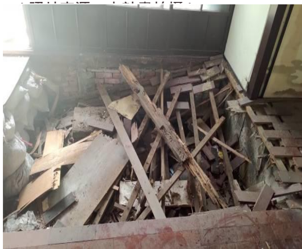
屋內木地板遭白蟻嚴重蛀蝕毀壞
