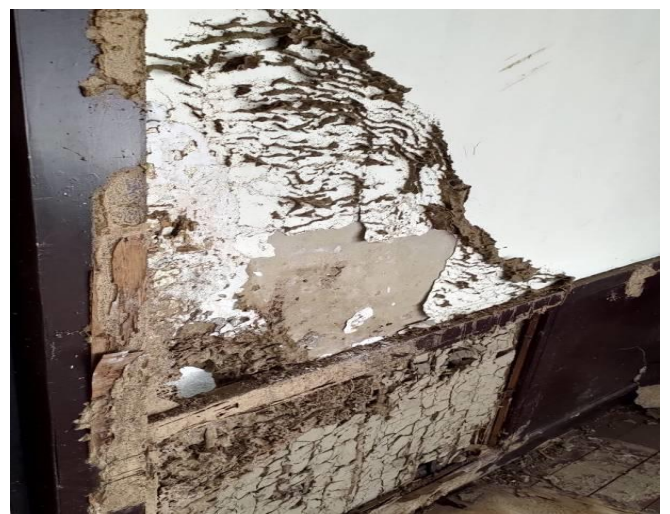
內牆蟻巢痕跡
