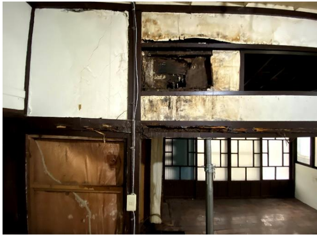
部分牆面因漏水導致受潮而發霉
